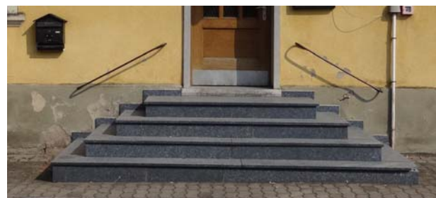
Passende Stufenform, falsches Material zum Sandsteinhaus
