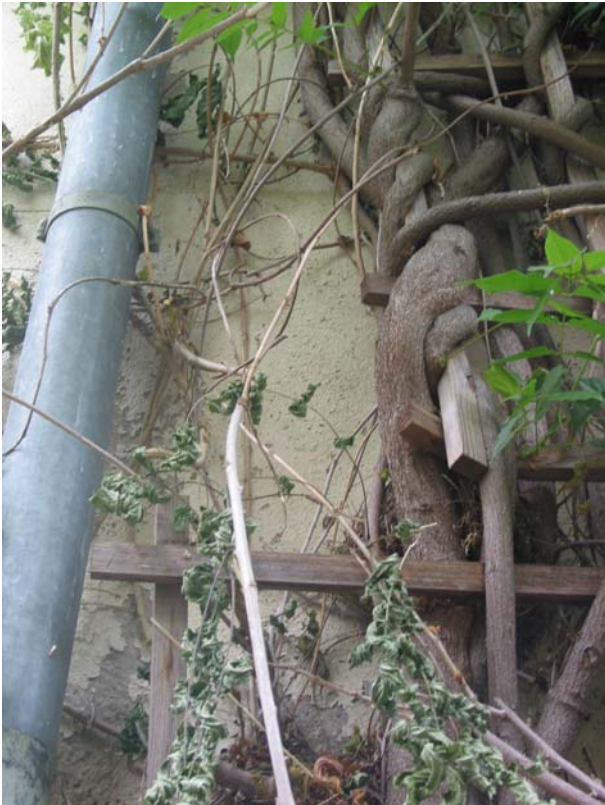
Starkwachsende Pflanzen benötigen robuste Rankhilfen. Dachrinnen können beschädigt werden.
