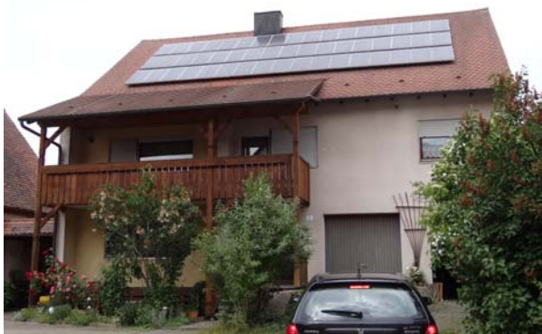
Balkon mit Schleppdach - Verschattung der dahinter liegenden Räume beachten!
