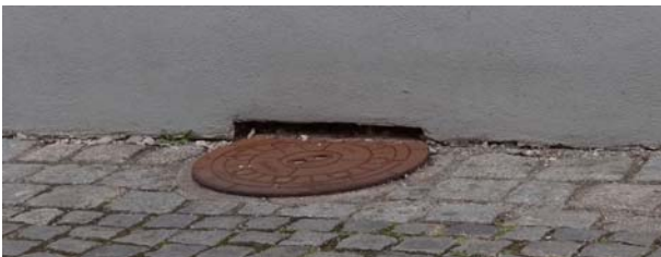
Außendämmung verdeckt zum Teil einen Versorgungsschacht am Straßenrand
