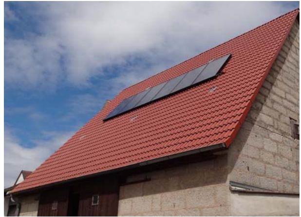
Photothermie- / Solarthermiezellen zur Warmwasseraufbereitung
